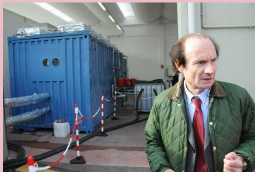
Теплогенерирующий комплекс мощностью 470 кВт
